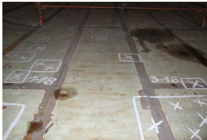
Slika 6. Deo pozicija mesta za sanaciju čeličnih limova poda rezervoara nakon završenog MFL ispitivanja
