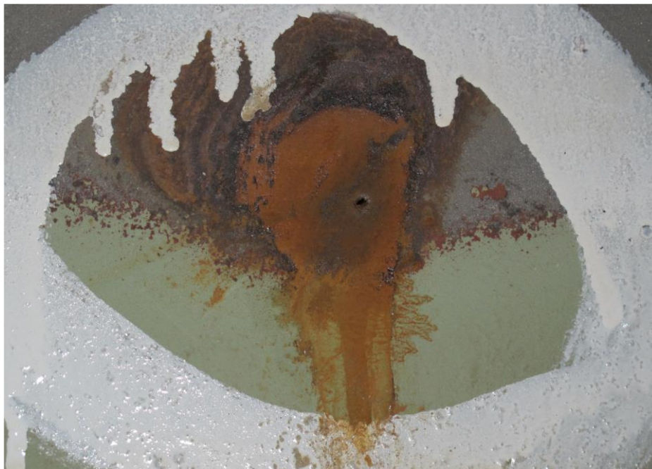
Slika 3. Prikaz oštećenja koje je počelo sa "donje" strane lima koje je nemoguće detektovati ultrazvučnim merenjem debljine lima a vizuelnom metodom se otkrije kad izbije na površinu (nastane rupa)
