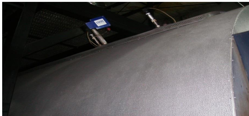
Slika 8. Uređaj za mjerenje i regulaciju vodljivosti kotlovske vode
