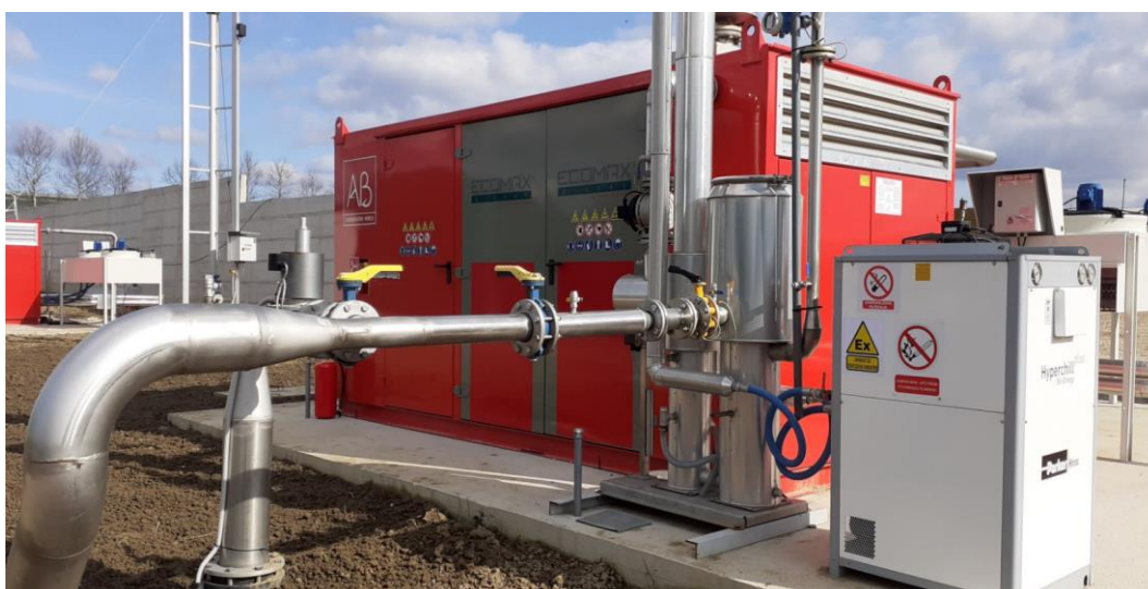
Slika 8. Izgled kontejnera za smještaj CHP jedinice
