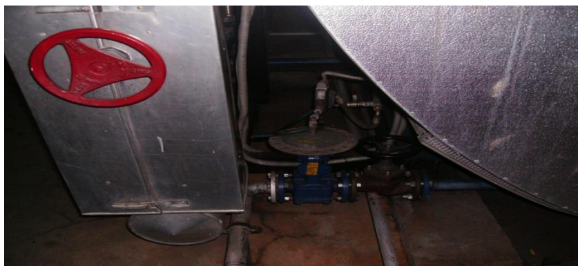
Slika 7. Automatski i ručni ventili za odmuljivanje kotlova u posmatranom pogonu
