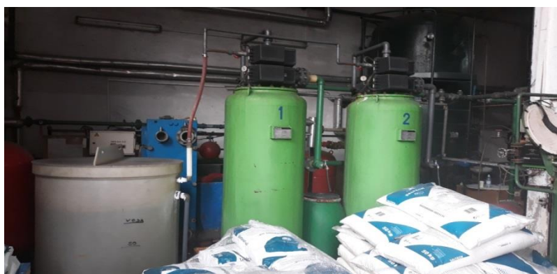
Slika 4. Dvostruki automatski omekšivač vode u posmatranom pogonu
