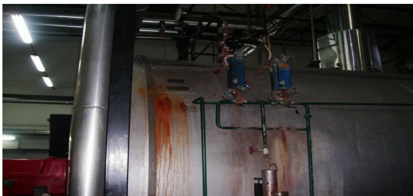
Slika 6. Ventil za uzorkovanje vode na kotlu posmatranom pogonu
