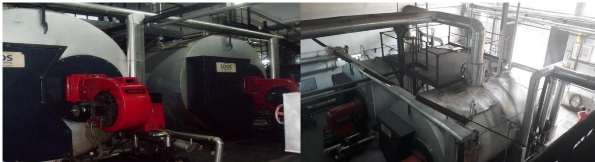
Slika 1. Kotlovi sa plamenicima ugrađeni u posmatranom pogonu
